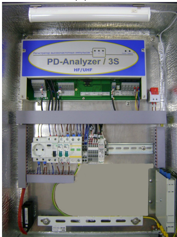
Рисунок 2. PD-Analyzer/3S внутри монтажного шкафа
