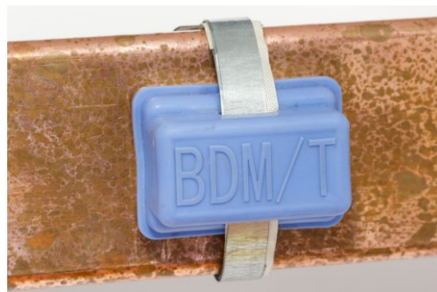
Крепление датчика BDM/T на медной шине КРУ.
